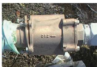
圧力調整弁の破損
