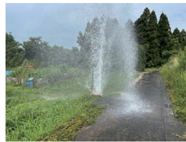
車両が給水栓に接触し漏水
