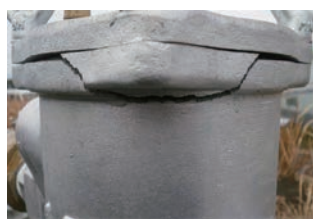
フィルターの破損
