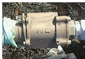
圧力調整弁の破損
