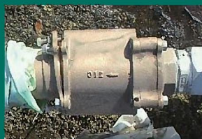
圧力調整弁の破損
