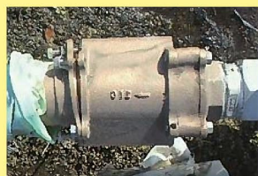
圧力調整弁の破損
