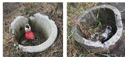
※トラクター用モアによる給水栓破損
